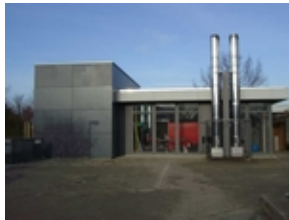
Pelletkessel mit Siloanlage für Schulzentrum
