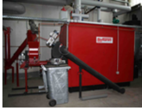
Pelletkessel mit Siloanlage für 419 Wohneinheiten
